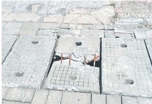
泰山南路与金江路交叉口向北约140米路西，人行道上污水井盖破损。
