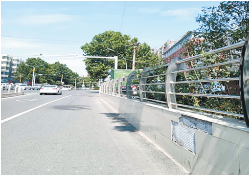
黄河中路与京广铁路交叉口向西约60米路口，护栏下方瓷片破损、脱落。
