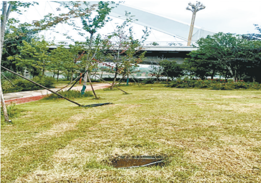
沙湾路与牡丹江路交叉口向北约10米景区绿化带内井盖缺失，存在安全隐患。
