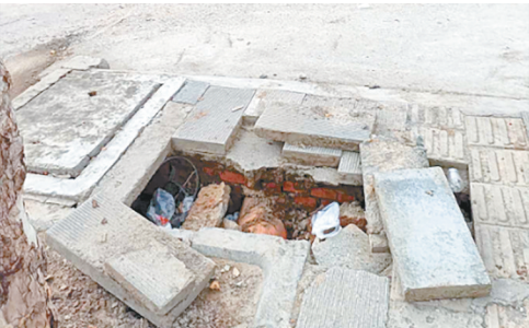
太白山北路与辽河路交叉口向北约100米路西，人行道地砖破损。
