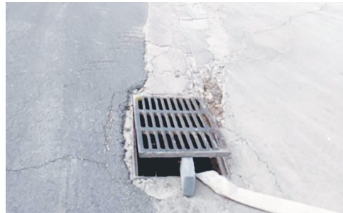
宝塔山路与泾河路交叉口西南角，工地排水未设警示标志。
