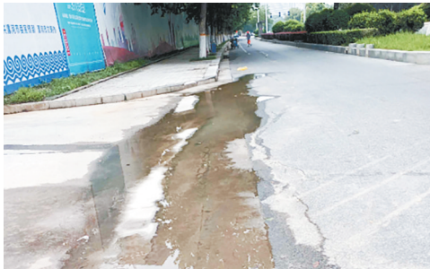
太白山中路与嘉陵江路交叉口向南约150米路西，有人乱排污水。
