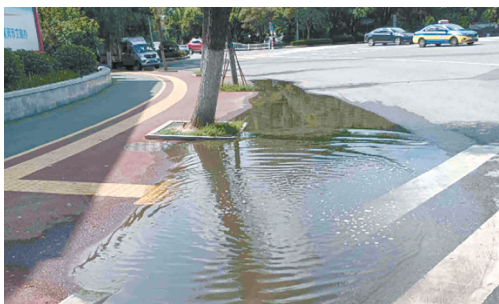
淞江路与金山北路交叉口向西约1米路南，排水管道堵塞，影响通行。
