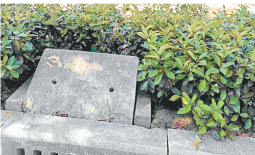
牡丹江路与邛山路交叉口向西约120米路北，绿化带内井盖移位。
