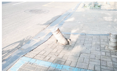
人民西路与螺湾南路交叉口向西约80米路南，便道桩倾斜。
