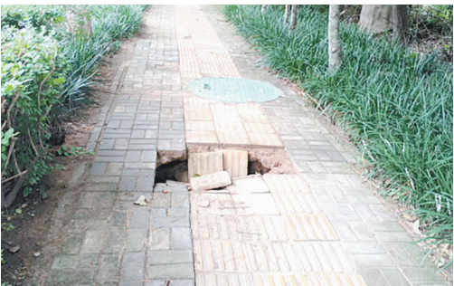
中山北路与渭河路交叉口向南约70米路东,人行道路面塌陷。
