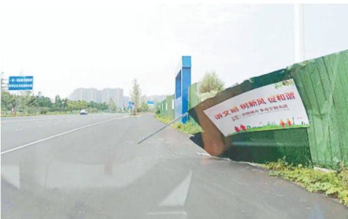
燕山路与牡丹江路交叉口向北约230米路西,围挡破损倾斜。
