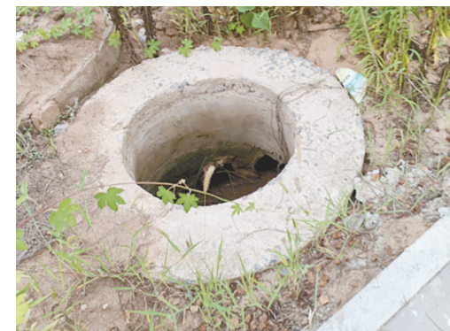
金山北路与龙江西路交叉口附近, 井盖缺失。
