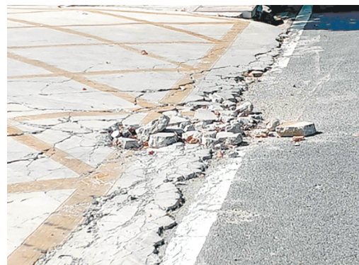
云翠山路与洋河路交叉口向北150米路东, 路面破损。
