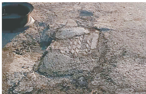
淞江路与太白山北路交叉路口向东约300米路南，井盖破损，存在安全隐患。
