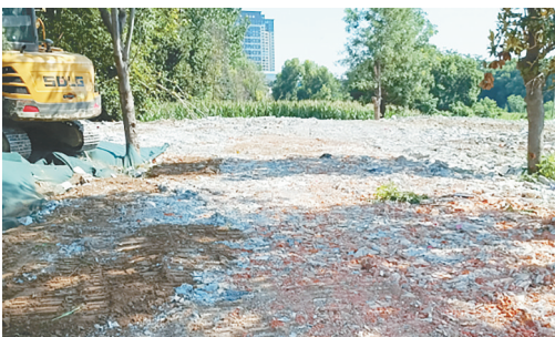
辽河路与太白山北路交叉路口向西约200米路北，渣土堆积。
