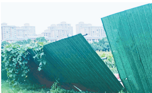
庐山路与黄河东路交叉口向南约60米路东，围挡损坏、倾斜。
