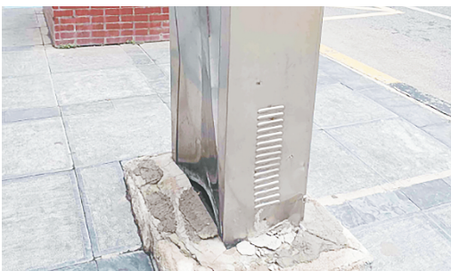
泰山南路与银江路交叉口向北约90米路西，人行道上路灯亮化柜损坏。
