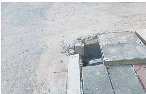
沙湾路与玉河路交叉口向北约100米，人行道上雨水井盖移位，存在安全隐患。
