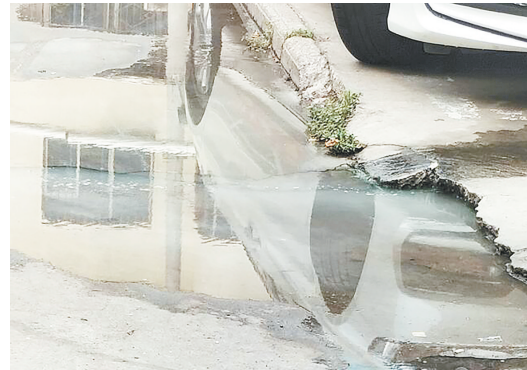
漯河三高家属院门口，下水道堵塞，污水外溢。
