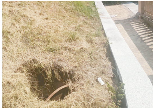
长江路与太白山中路交叉口向西约100米路北，井盖下陷。
