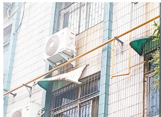
龙塔路与太行山路交叉口向东约30米至80米之间路南，临街楼雨搭破损。
