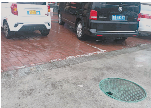
滦河路与燕山路交叉口向西约25米路南，人行道上电力井盖破损。
