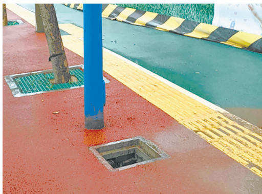
交通南路与樟江北浦路交叉口向北约50米路西，路灯井盖缺失。
