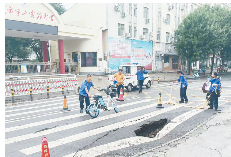
9月12日下午,市第二实验中学南校区大门前路面突然出现塌陷。在附近巡逻的源汇区城市发展服务中心工作人员发现后,立即拉起警戒线,进行交通疏导,提醒居民和过往车辆小心通行,并通知相关部门工作人员前往维修。本报记者 杨光 摄
