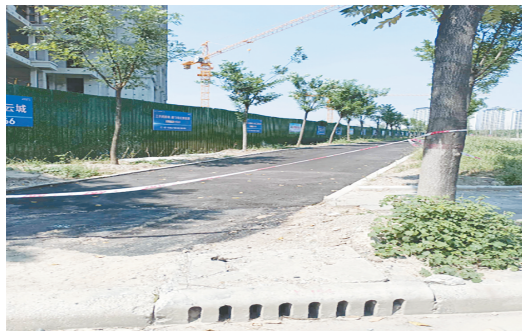
丹霞山路与柳江路交叉口向南约60米路西,人行道上污水井盖破损。
