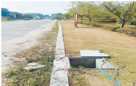
五泉山路与牡丹江路交叉口向北约160米路西,绿化带内雨水井盖破损、移位。
