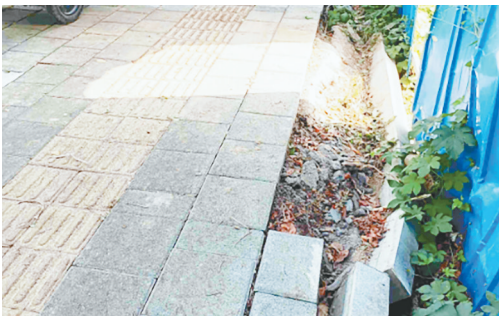
燕山路与洋河路交叉口向北约120米路东，道边石移位。
