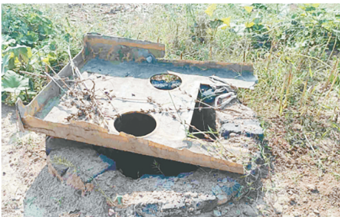
燕山路与龙江东路交叉口向南约30米路西，井盖缺失。
