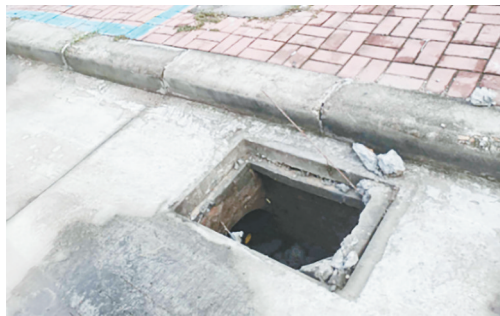
太行北巷与太行山南路交叉口向东约120米路南，井盖缺失。
