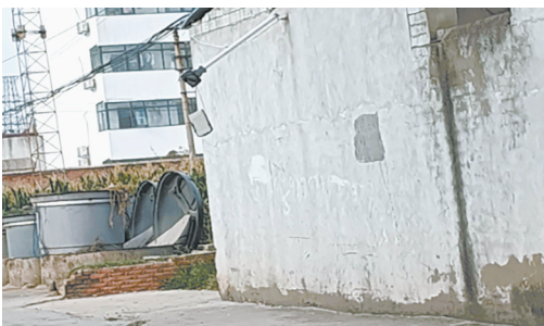
渭河路与桐柏山路交叉口向西约200米路南，路灯破损。
