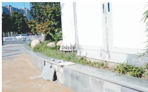
泰山南路与银江路交叉口向南约5米路东,花坛瓷砖破损、脱落。
