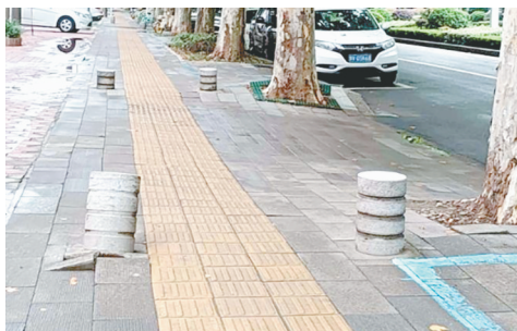
黄河中路与舟山路交叉口向西约50米路南,便道桩倾斜且底部松动。
