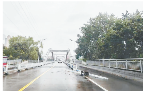
市区泰山路沙河桥，北边部分护栏破损。
