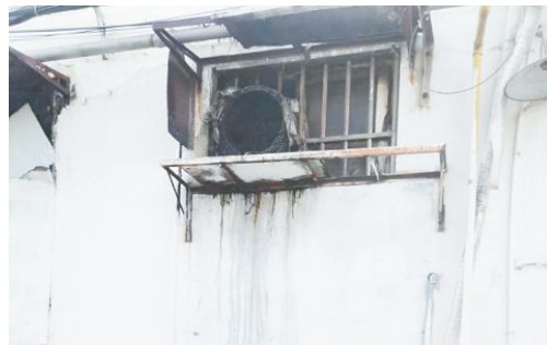
湘江路农资1号院,一饭店未安装油烟净化器,油污直接排到小区里。
