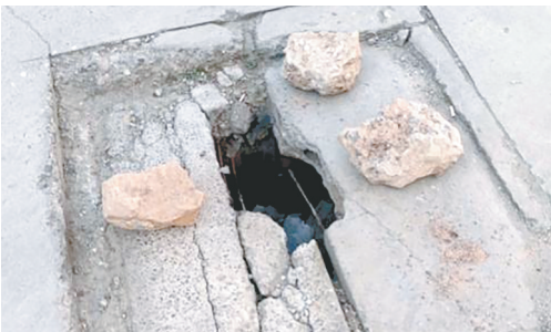
辽河路与白云山北路交叉口向西约200米处，污水井盖破损。
