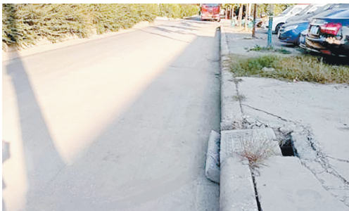
淞江路与白云山北路交叉口向西约450米路南，污水井盖移位，周边破损。
