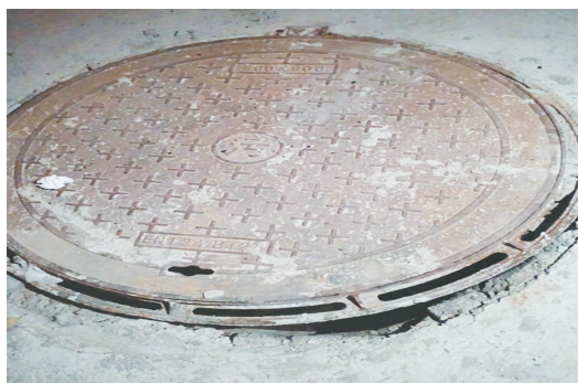
黄河西路与大南街交叉口向西约280米路南,人行道污水井盖周围破损。
