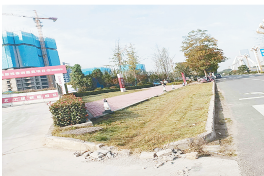
牡丹江路与云翠山路交叉口向东约280米路南,绿化带半侧石破损。
