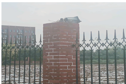
古城路与芙蓉江东路交叉口向南约60米路西,围墙上的景观灯损坏。
