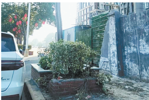
金江路与嵩山南路交叉口向东约230米路南，花坛围墙破损。
