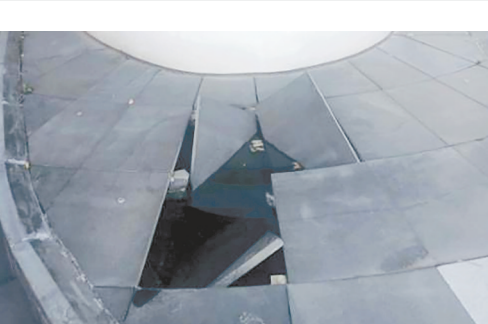
月龙湖西路与太白山中路交叉口向西约190米路南,喷泉池内瓷砖破损。
