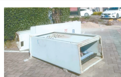
嵩山西支路与会展路交叉口附近,建业壹号中心消防栓控制柜倒地。
