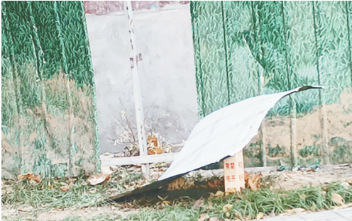
韶山南路与青龙山路交叉口东北角，工地围挡破损。
