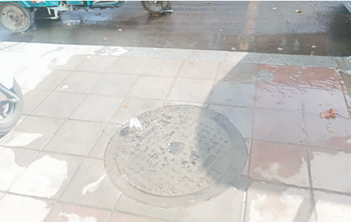
子牙河路与千山路交叉口向西约70米路北，人行道上排水管道堵塞，污水外溢。
