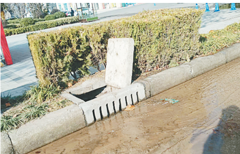
中山北路与人民东路交叉口向北约100米路西,绿化带内雨水井盖移位。
