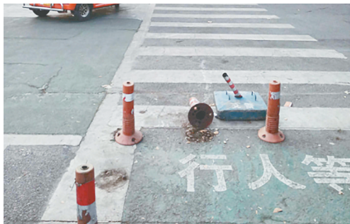
泰山北路与黄河中路交叉口向北约1米路西,人行横道桩倒地。
