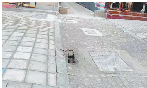
祁山路与黄河西路交叉口向南约40米路东，人行道上路面塌陷。
