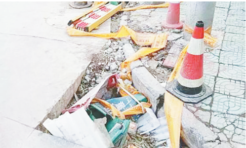
黄山支二路与黄山支一路交叉口向北约1米路东，施工后路面未恢复。
