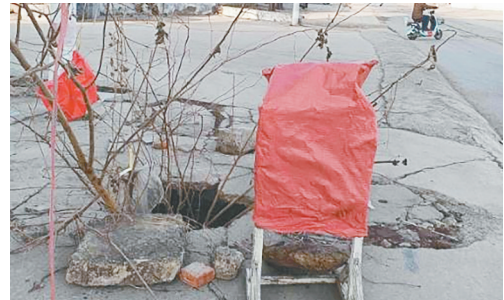
金江东路与金山南路交叉口向西约250米路南，沟槽盖板破损，存在安全隐患。
