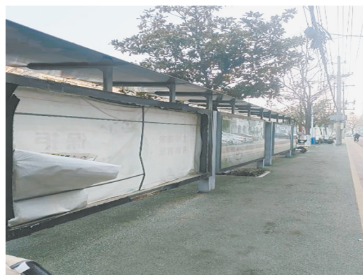
海河路与崂山路交叉口向西约60米路南，公交站亭损坏。
