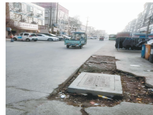
岷山路与阮庄路交叉口向南约2米路西，施工完成后路面未恢复。
