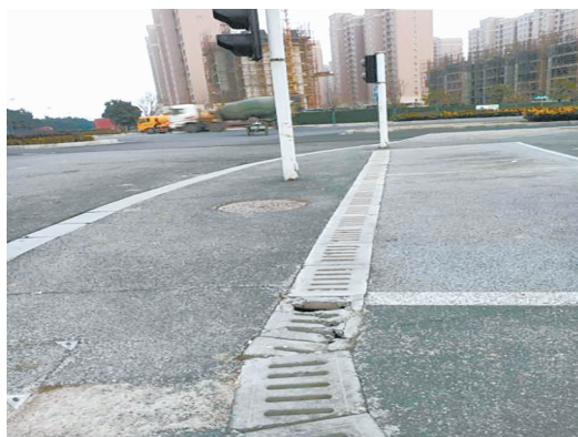
洋河路与燕山路交叉口向西约10米路南，雨水井盖破损。
