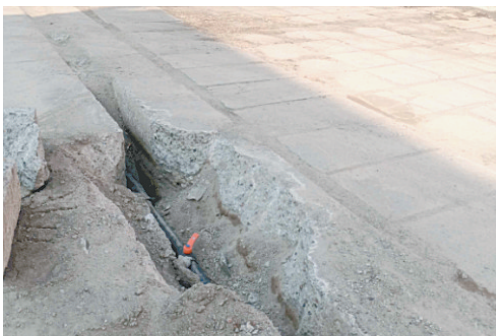
渭河路与桐柏山路交叉口向西约260米路北，施工结束后路面未恢复。
