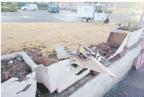
淞江路京广铁路涵洞西侧，有花盆破损、缺失。
