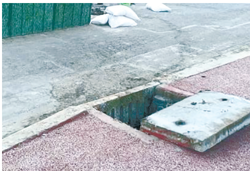
中山北路与黄河路交叉口向南约25米路西，井盖移位。
