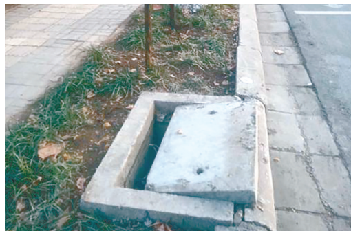
中山北路与汾河路交叉口向北约90米路东，井盖移位。
