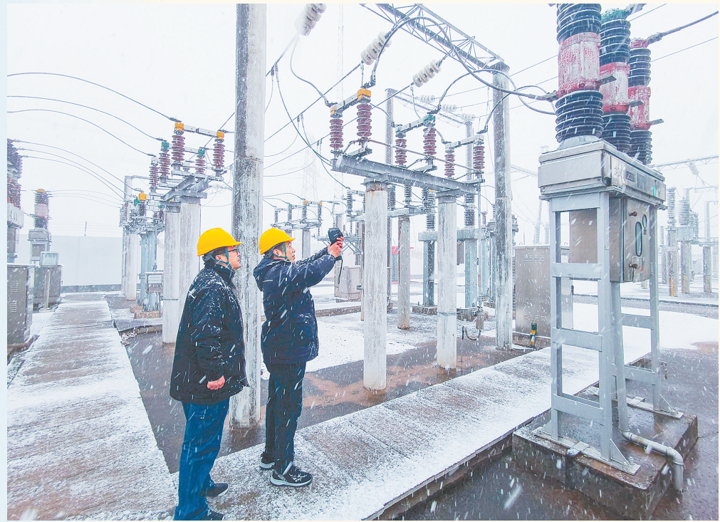
国网漯河供电公司运维人员对变电站设备进行测温,了解设备运行情况。
