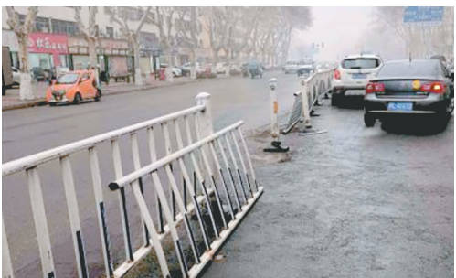
湘江西路与交通南路交叉口向西约120米，交通护栏损坏。
