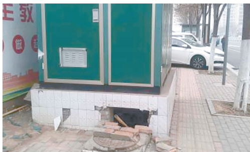
泰山北路与嫩江路交叉口向北约10米路西，路灯控制柜底座损坏。
