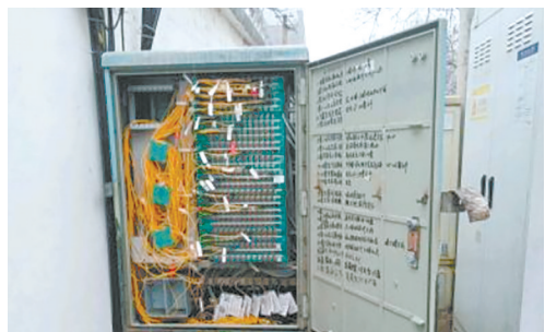
舟山路与海河路交叉口向北约50米路西，通信交接箱门未关。
