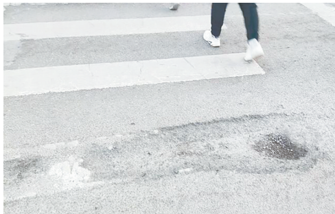
黄路路与泰山路交叉口,斑马线处路面破损。
