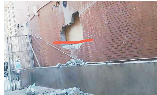
长江路与乐山路交叉口兴和苑小区8号楼西外立面,一楼商户违规砸墙,存在安全隐患。
