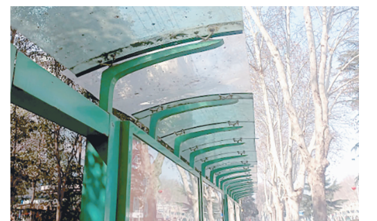
黄河路与黄山路交叉口向东约70米路南, 公交站亭顶棚有污渍。
