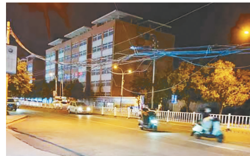
祁山路与淦江路交叉口向北约50米路西,线缆低垂。
