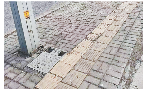
龙江西路与太行山北路交叉口西北角,窨井盖破损。
