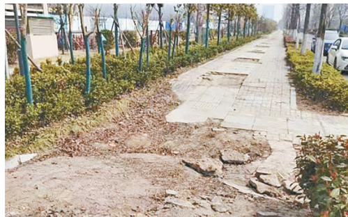
牡丹江路与邛山路交叉口向西约170米路北,人行道地砖破损、缺失。
