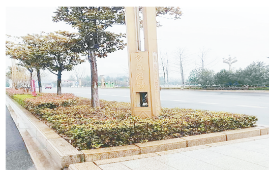
牡丹江路与中山路交叉口向西约80米路北,绿化带内路灯杆盖板缺失。
