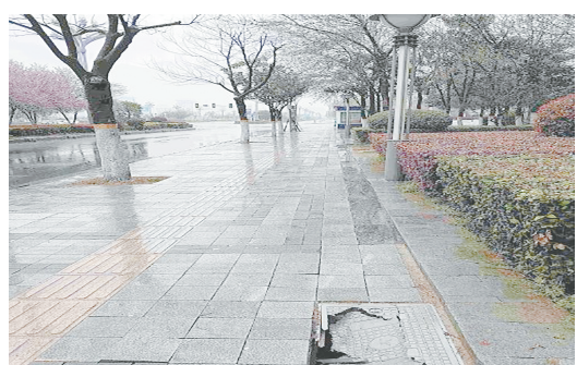
长江路与九龙山路交叉口向西约60米路南,人行道上井盖破损。
