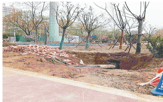
桐柏山路与黄河东路交叉口向南约10米路东,绿化带内施工无围挡,存在安全隐患。
