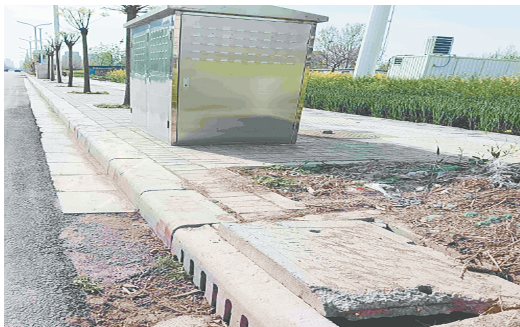
漯河路与玉山路交叉口向东约220米路北,污水井盖破损。
