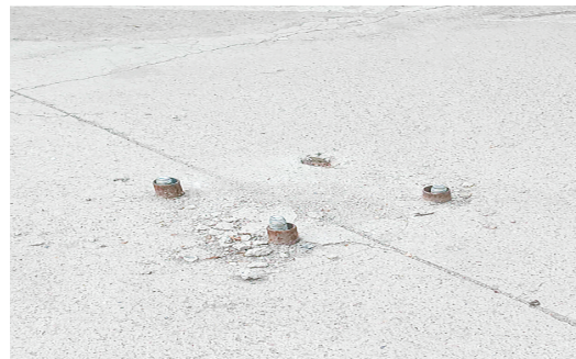
嵩山南路与湘江西路交叉口向北约50米路东,路面有设施残留物。
