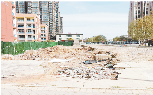
井冈山北路与淞江路交叉口向北约30米路西,幸福港售楼部拆除后,路面未恢复。
