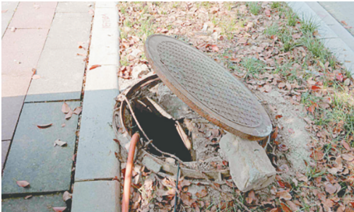
沙湾路与牡丹路交叉口西南角,绿化带内井盖移位,存在安全隐患。
