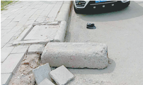
梅花山路与桂江路交叉口向北约100米路东,道边石移位。
