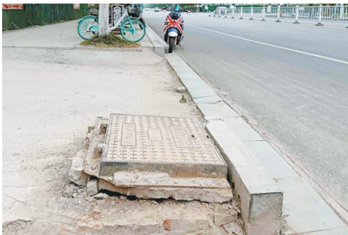
泰山北路与会展路交叉口向南约60米路西，窞井盖破损。
