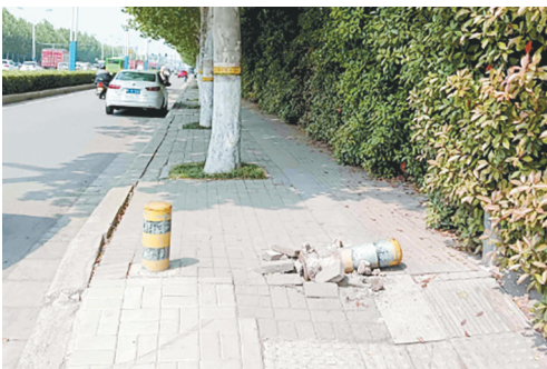
白云山北路与淞江路交叉向北约60米路东，人行道隔离桩损坏。
