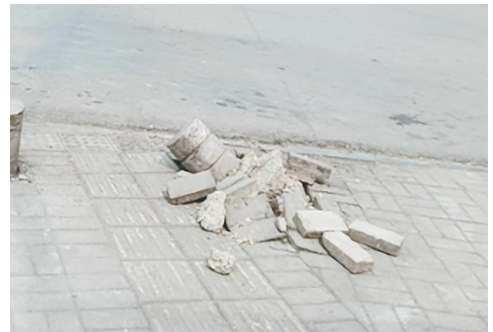
人民西路与螺湾南路交叉口向西约1米路南，便道桩损坏。
