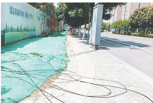
嘉陵江路与太白山中路交叉口向西约10米路南，架空线缆脱落。
