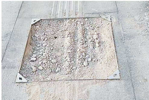
太行山北路与沙北路交叉口向南约60米路东，人行道破损。
