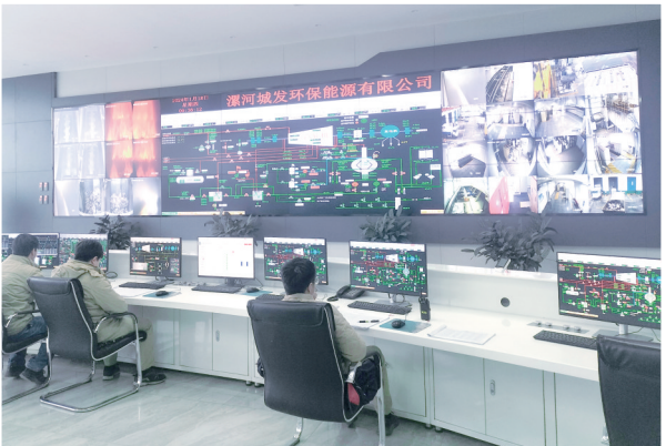
生活垃圾焚烧发电项目监控大厅
