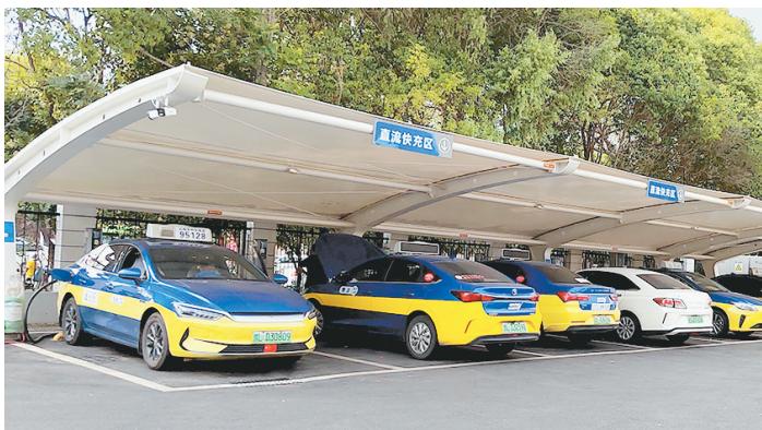
新能源车在市政集团综合充电站（湘江路站）充电。
