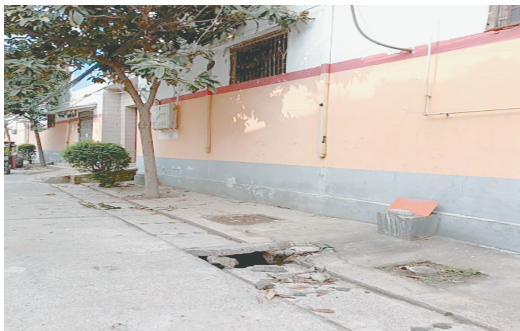
京广路与校园街交叉口向南约60米路东,沟槽盖板损坏。
