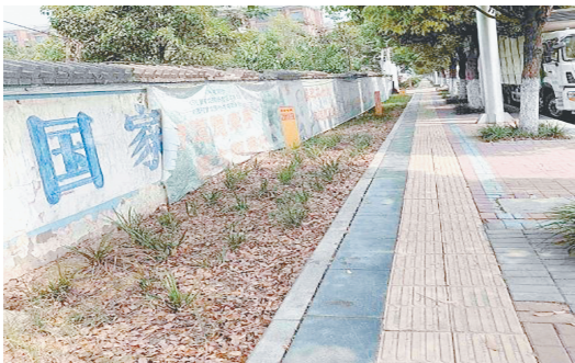
衡山路与樟江东路交叉口向北约20米路西,墙上公益广告破损。
