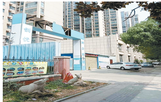
乐山路与汉江路交叉口向北约120米路西,源汇区南关村改造项目工地门头广告破损。
