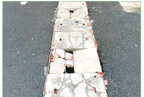
泰山南路与金江路交叉口向北约150米路西，人行道上下水道盖板破损。
