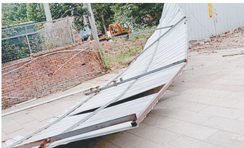
桂江路与白云山南路交叉口向西约80米路北,围挡倒地。
