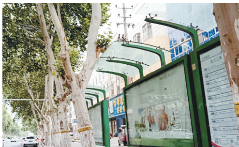
人民东路与金山南路交叉口向东约120米路南,公交站顶棚玻璃破损。
