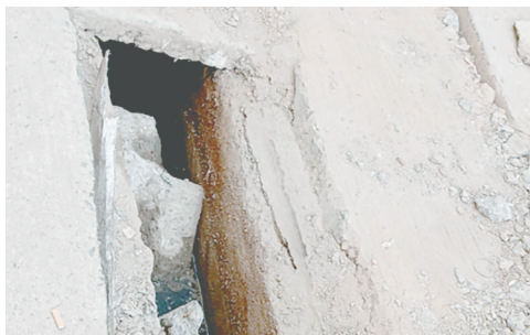
渭河路与银鸽路交叉口向东约300米路北,沟槽盖下陷。
