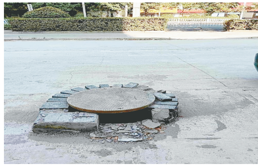
太行山北路与淮河路交叉口向北约20米路东,污水井盖周边破損。
