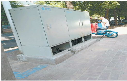
马路街与铁匠巷交叉口向东约5米路南,通信交接箱箱门缺失。
