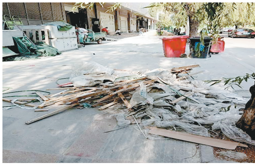
黄山支一路与泰山路交叉口向西约60米路北,人行道上施工废弃物。
