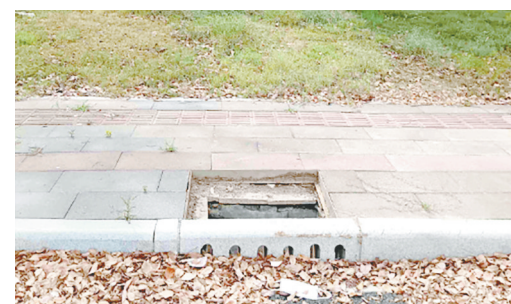
云翠山路与牡丹江路交叉口向北约70米路西,人行道上井盖缺失。
