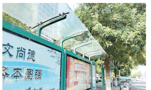
人民东路与解放南路交叉口向东约100米路北,公交站亭顶棚破损。
