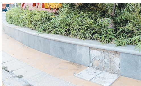
泰山南路与银江路交叉口向南约5米路东,花坛瓷砖脱落。
