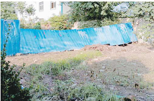
赣江路与燕山南路交叉口向东约180米路北，围挡破损倾斜。
