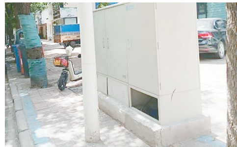
马路街与铁匠巷交叉口向东南约10米路南，人行道上通信交接箱门缺失。
