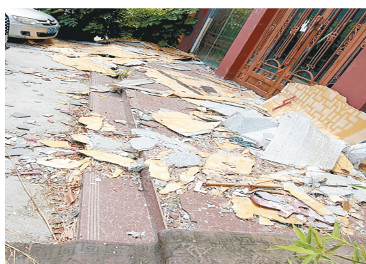
翠华山路与长江路交叉口向南约20米路西，闽商大厦展示中心门前垃圾未清理。
