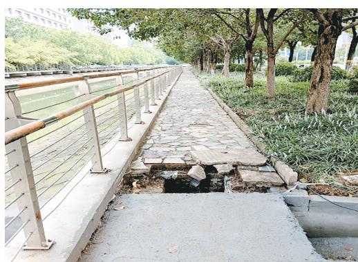
黄河东路与桐柏山路交叉口向东约120米路北，绿化带后人行道上污水井盖破损。
