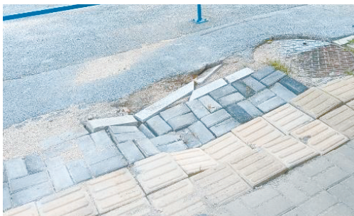
嘉陵江路与王屋山路交叉口向西约10米路南,路面塌陷。
