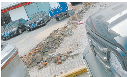
泰山南路与湘江西路交叉口向南约90米路东,临街门店装修施工遗留渣土未及时清理。
