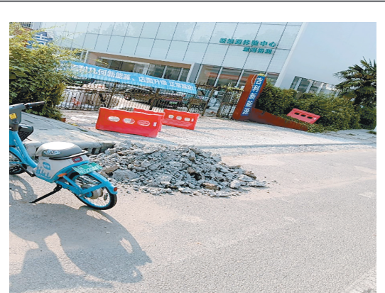
梅花山路与湘江西路交叉口向北约30米路西,施工后渣土未清理。
