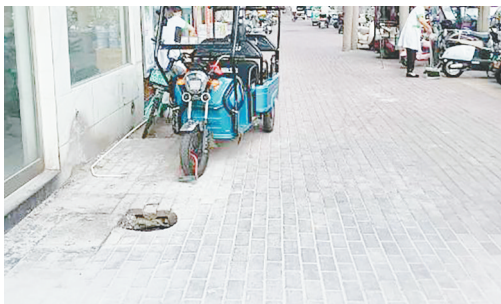
漓江路与衡山路交叉口向西约50米路南,疑似污水井盖缺失。
