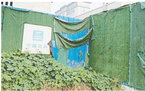
王屋山路与汉江路交叉口向南约60米路东,围挡上的绿网破损。
