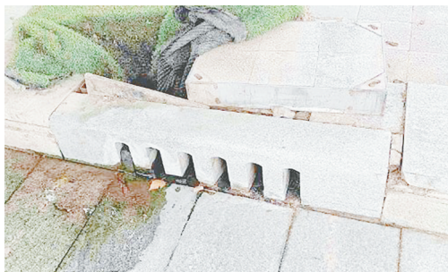
太白山中路与月湾湖东路(北)交叉口向北约10米路东,雨水井盖移位。
